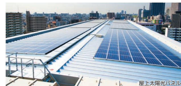
屋上太陽光パネル
