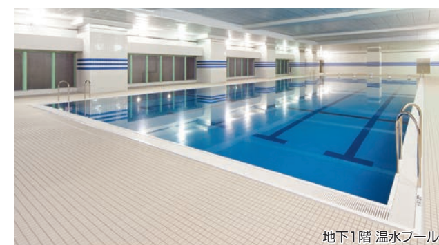
地下1階 温水プール
