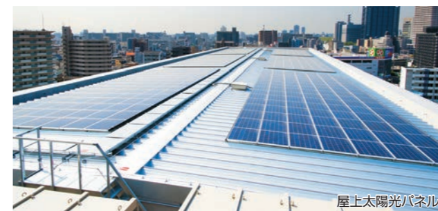
屋上太陽光パネル
